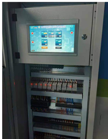
图 3-7 衰变池控制系统实物图
